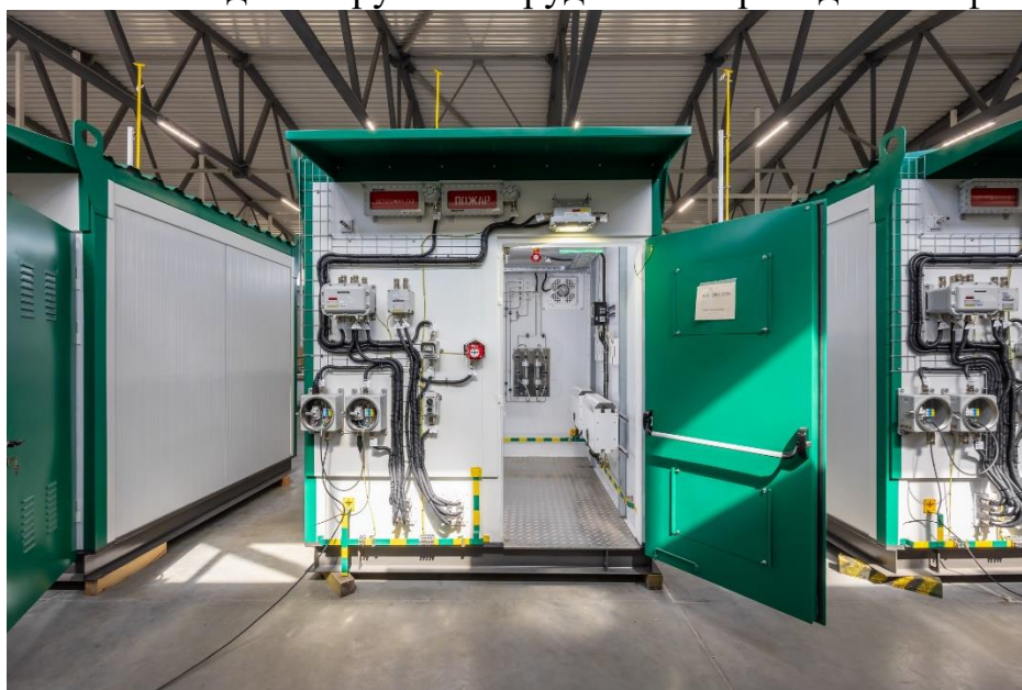
Фото 3. Блок-бокс с автоматическим пробоотборником
